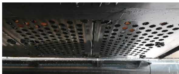
优化散热结构 主泵罩盖及维修孔板等增加透气孔提高散热性
